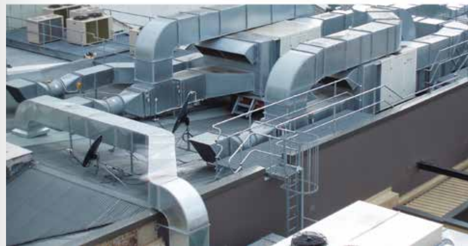
Ống thông gió / Duct Pipes
